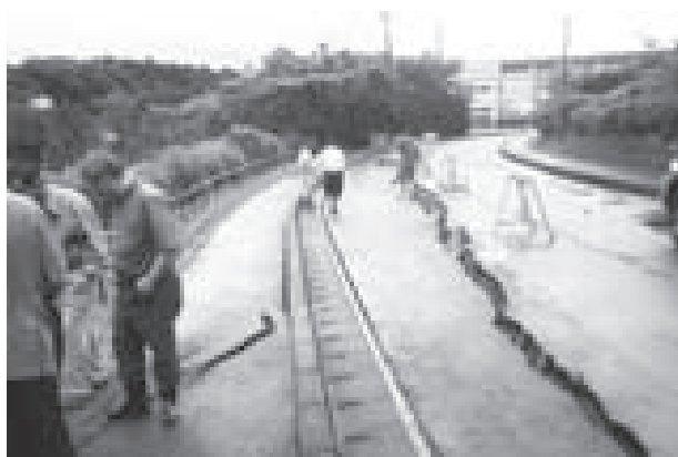
▲道路の陥没、亀裂がはげしい現場
