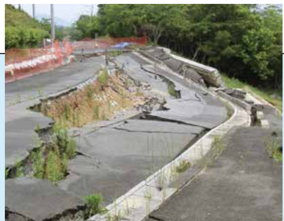
▲現在の被災道路の様子
