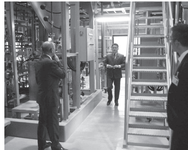
▲クリーンパーク有田（浸出水処理施設）
