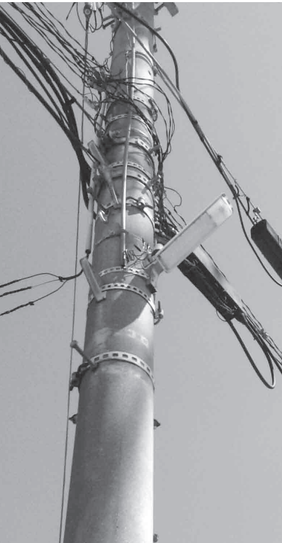
▲LED化された防犯灯
